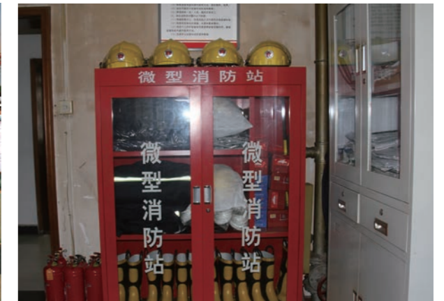
配备有多套消防头盔、消防服装等应急火灾救援消防硬件的微型消防站
